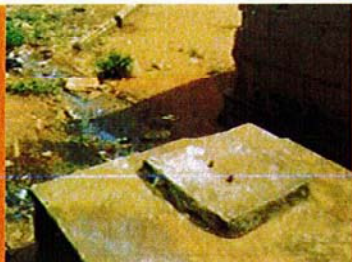
Septic tank with surfacing effluent, Abidjan, Cote d'Ivoire.
